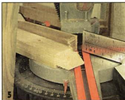
Запиленные «на ус» концы шипов обеспечивают стыковку двух перемычек и позволяют получить прочное соединение.
